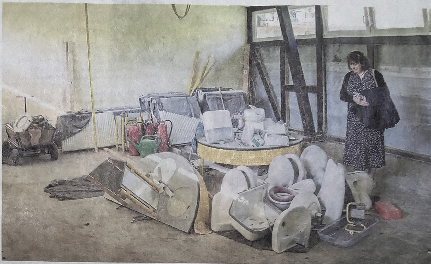
Kita-Leiterin Karin Kraus zeigt die abmontierten Sanitäranlagen.
